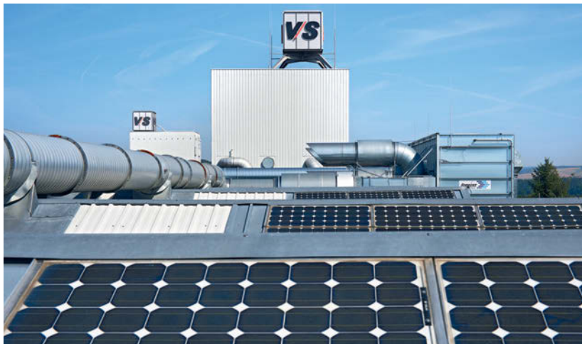
Fotovoltaik-Anlagen auf den Dächern der VS-Werke (oben), Rohranlage zur Absaugung der Holzspäne aus der Produktion, die später thermisch verwertet werden.
